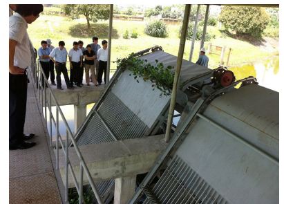
Thiết bị vớt rác tại trạm bơm Vân Đình - Hà Nội
