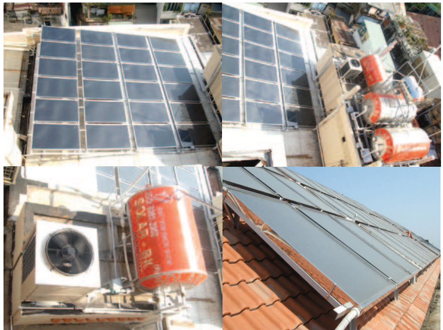
Hệ thống máy nước nóng năng lượng mặt trời tại KS. Norfolk
